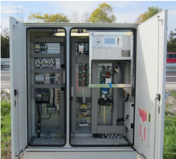
Innenleben einer Streckenstation
